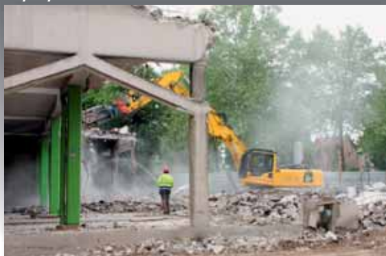
Mai à août 2009 : démolition du marché couvert et préparation du chantier de construction
